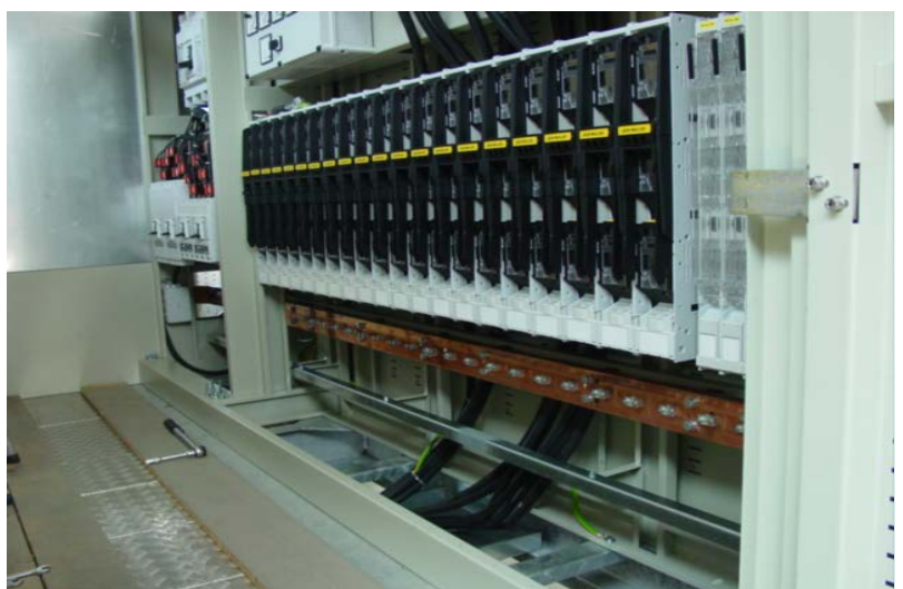
Beispiel Ausführung Niederspannungsverteiler
